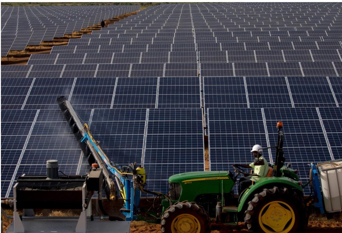
Die grösste Solaranlage Westafrikas steht in Bokhol, Senegal. Auf 35 Hektaren produzieren 75 600 Solarpanels 20 Megawatt Elektrizität. Ermöglicht wurde das Projekt durch eine gemischte Finanzierung. Foto: Pascal Maitre
